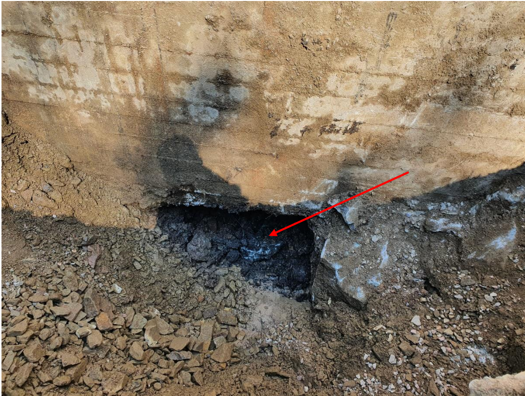
Figur 4: Kvarlämnad förorening under byggnadens fasad. Bildkälla: AFRY 2021-07-19.
